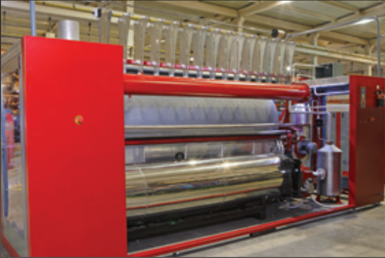
Gaz Isıtma Sistemi
